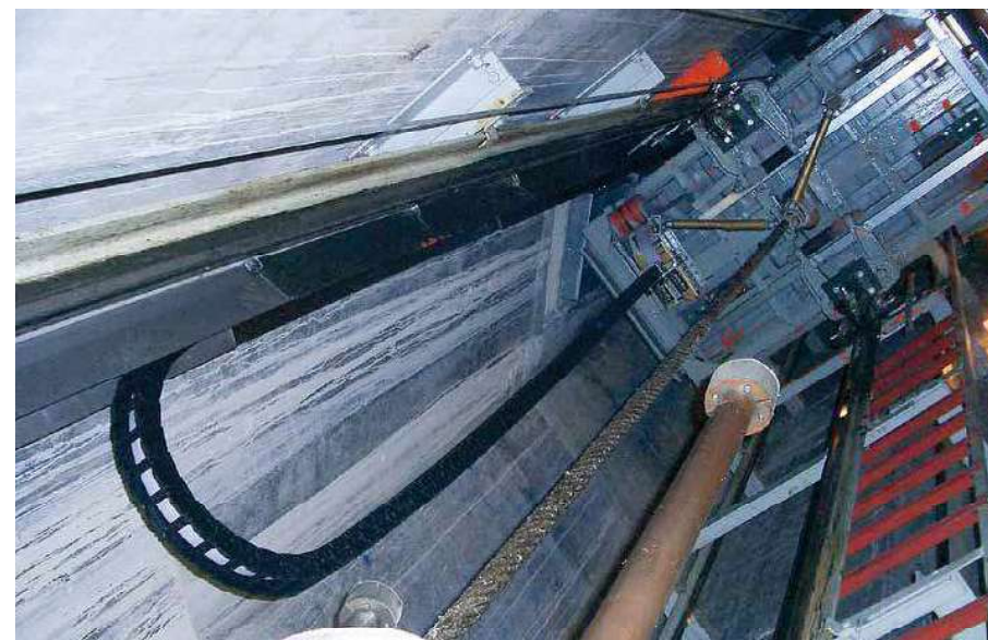
E2/000 - robustní systémy napájení na 160 m pojezdu výtahu pro poštovní věž v Bonnu při současných konstantních nárazech vzduchu a z toho vyplývajících kyvadlových pohybech
